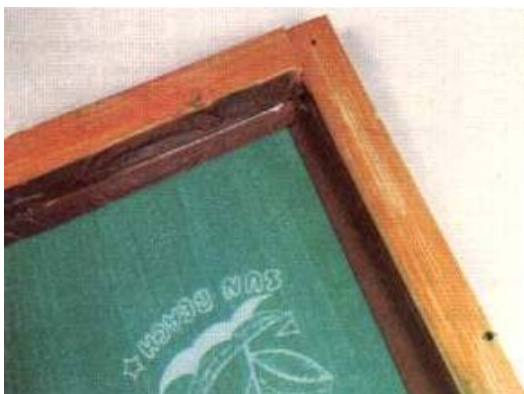
FOTO 33 - ...e na parte interna do quadro.
